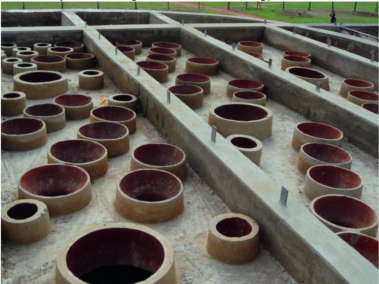
8. Die Räume zwischen den Töpfen sind betoniert und die Holzschalung drunter kann entfernt werden.
